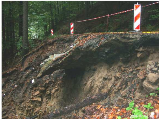
Abb. 1: Unterspülte Straße zur Janismühle
