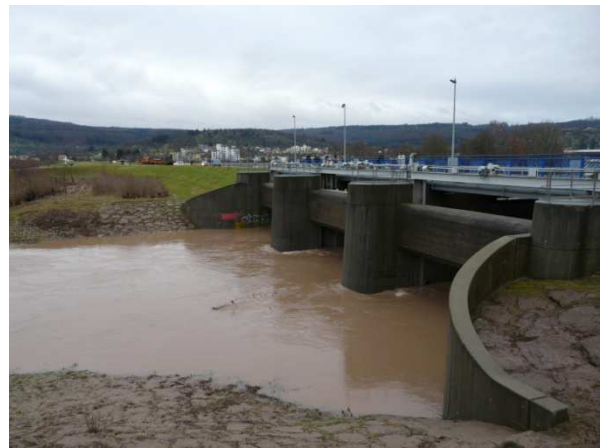
Abb. 7: Einstau einen Tag später
