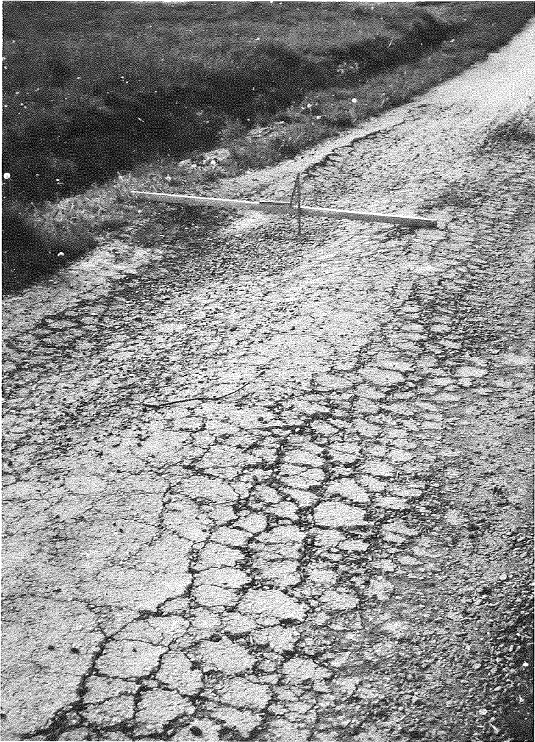
Bild 7 Fahrbahnschaden (Schadensstufe IV) infolge unzureichender Tragfähigkeit des Bodens (Versuchsstrecke Zinzenzell, Weg Nr. 28)
