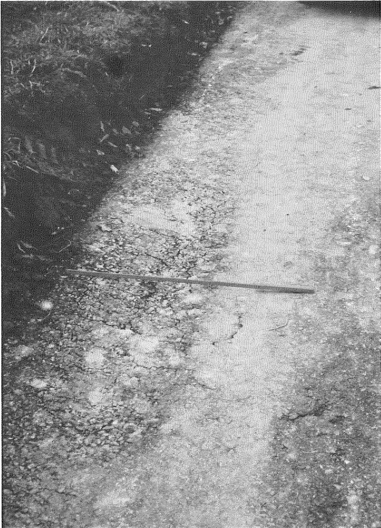
Bild 2 AOB-Wegebefestigung tiefer liegend als die Gelände- oberfläche mit Fahrbahnschaden infolge Schichtwasser (Versuchsstrecke Nr. 116 025 in Aicha v.Wald)
