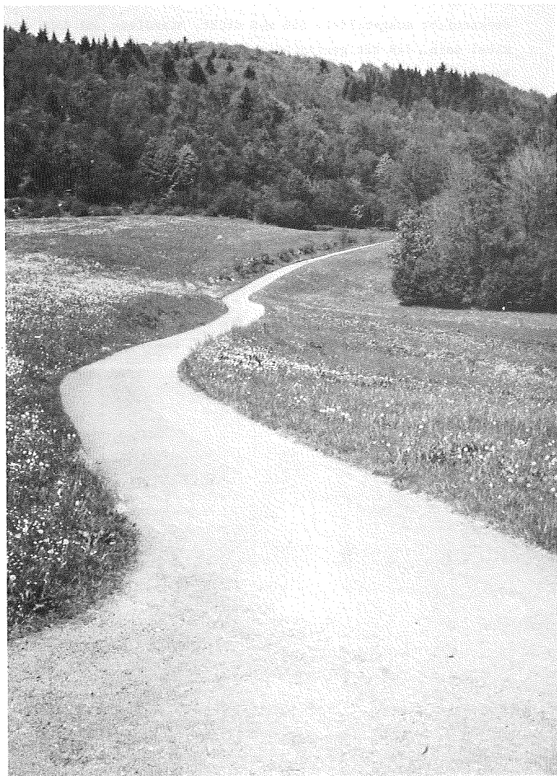
Bild 4 AOB-Wegebefestigung im Grünland mit guter Geländeanpassung; weitgehend fließender Übergang von Fahrbahn zum Gelände (Ältere AOB-Strecke in Germansdorf, Weg Nr. 58)
