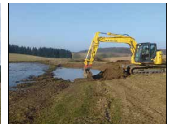
Abb. 3: Vergrößerung des kleinsten Maars der Eifel – der Hetsche – durch Wegerückbau – FB-Verfahren Schalkenmehren/Udler
