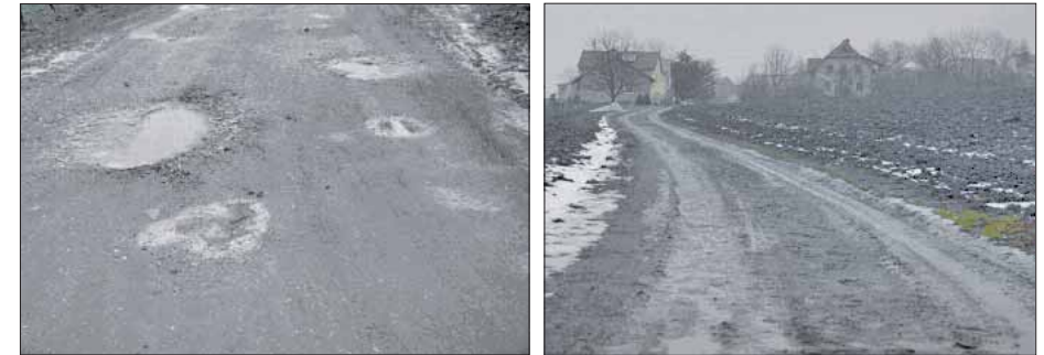
Abbildung 9: Schotterwege und Schadbilder
