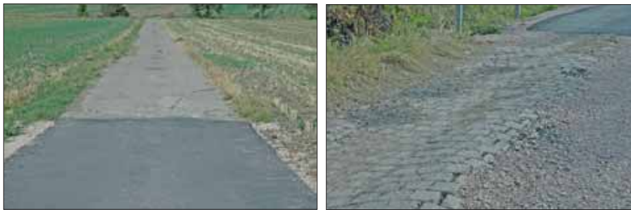
Abbildung 8: Schäden an Asphalt- und Pflasterwegen
